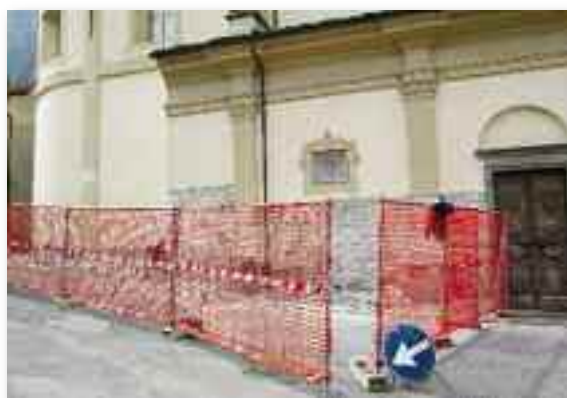
L'inizio dei lavori: rimozione dello zoccolo in graniglia e della calce deteriorata
